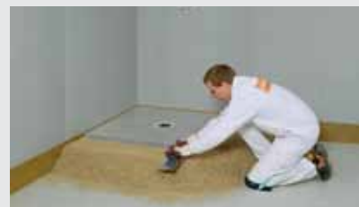
Varianta 1b: kolem sprchového prvku je ve výši přesahujícího stupně nasypána cca 200 mm široká hráz jako základ pro stažení zbývajících ploch
