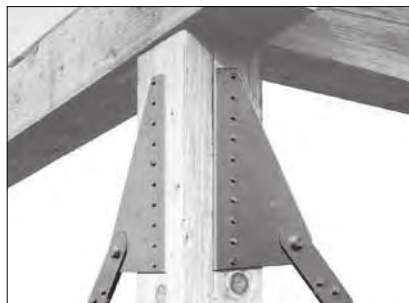
Detail an Eckstütze: Bandanschluss BNF25 mit Kopplungsverbinder BNKK25. Der gekantete Abschnitt des BNF25 ist in einem 70 mm von der Stützenkante entfernten, 16 mm tiefen Schlitz eingelassen.
