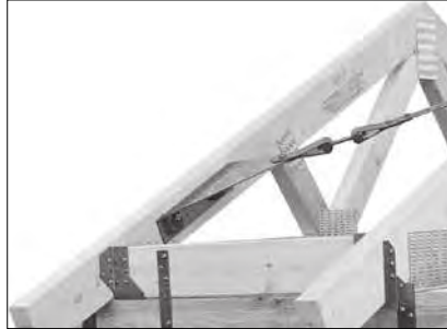
Detail am Traufpunkt: Bandanschluss BNG25 und Spanngerät BNSP25 mit Bolzen M12 durch den Sparren befestigt. In gleicher Weise kann der Bandanschluss BNG25 an Betongiebeln gehalten werden.
