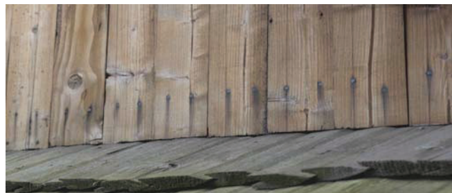
Pro upevnění prken byl použit nevhodný spojovací materiál, dřevina je v okolí spojovacího materiálu zabarvená stékající rzi.
