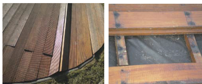
Následek nevhodně použitých ocelových pozinkovaných vrutů do terasy z dubu. Dřevina v okolí vrutů zabarvená, vruty přestříhány vlivem prnutí palubek a zasaženy červenou korozí.
