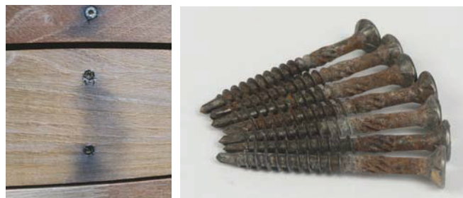
Následek nevhodně použitých ocelových pozinkovaných vrutů do venkovního dřevěného obkladu z akátu. Stav zhruba po 4 měsících po zhotovení spojů. Dřevina v okolí vrutů zabarvená, vruty zasaženy červenou korozí.
